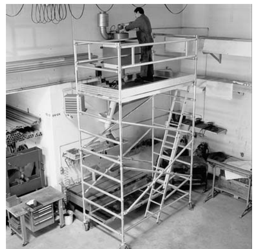
Bild 6: Fehlender Seitenschutz und mangelhafte Rollgerüstbeläge führen zum Absturz von Personen.
